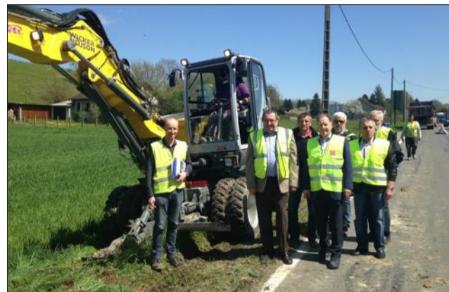
Une visite a permis de vérifier le bon déroulement des chantiers, en présence du président Daniel Vitte, des vice-présidents Daniel Rabatel et Henri Rivière, du directeur technique Vincent Bouvard, du bureau d'études chargé de la maîtrise d'œuvre, du coordinateur de sécurité, des entreprises, sous l'œil du maire, Gérard Vitte.
